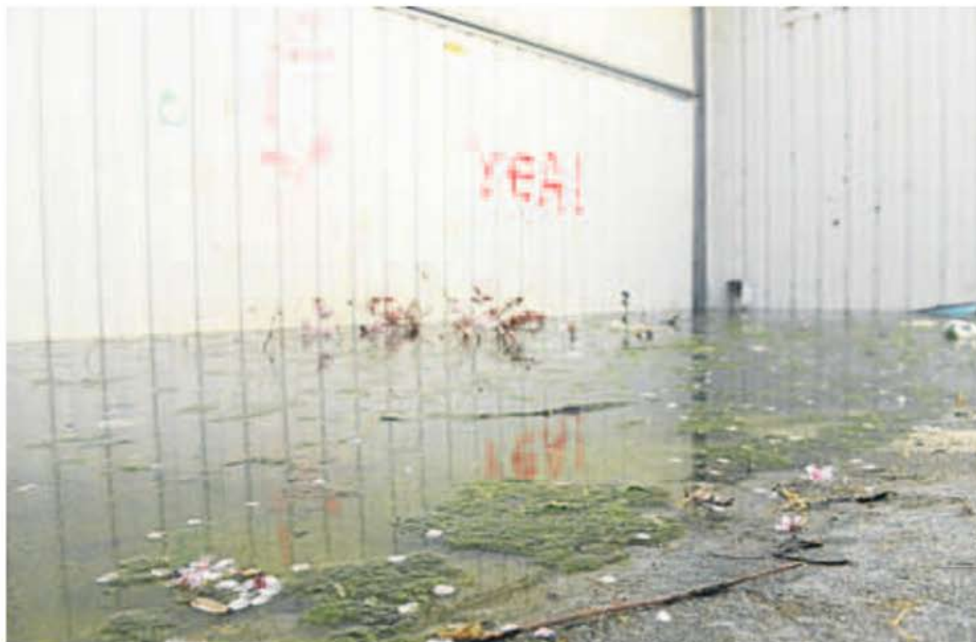
El agua rebosa por la rampa de entrada y salida al aparcamiento sin uso de La Victoria. RODRIGO JIMÉNEZ
